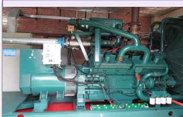
โรงไฟฟ้าชีวมวล
